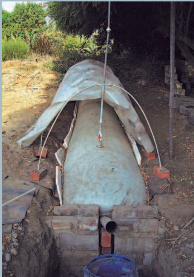
Biodigestor de geomembrana 📷 T. Gianella
