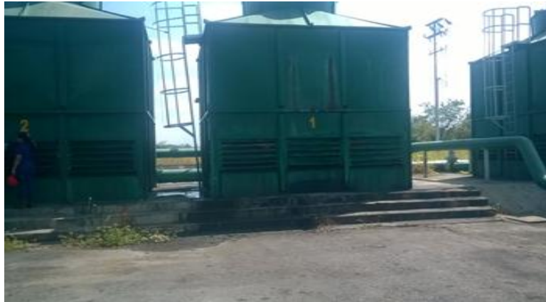
Figura N° 4. Torre de enfriamiento.
