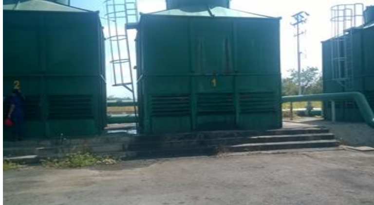
Figura N° 4. Torre de enfriamiento.
