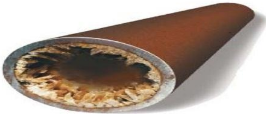
Figura .7. Incrustación en tubería de producción
