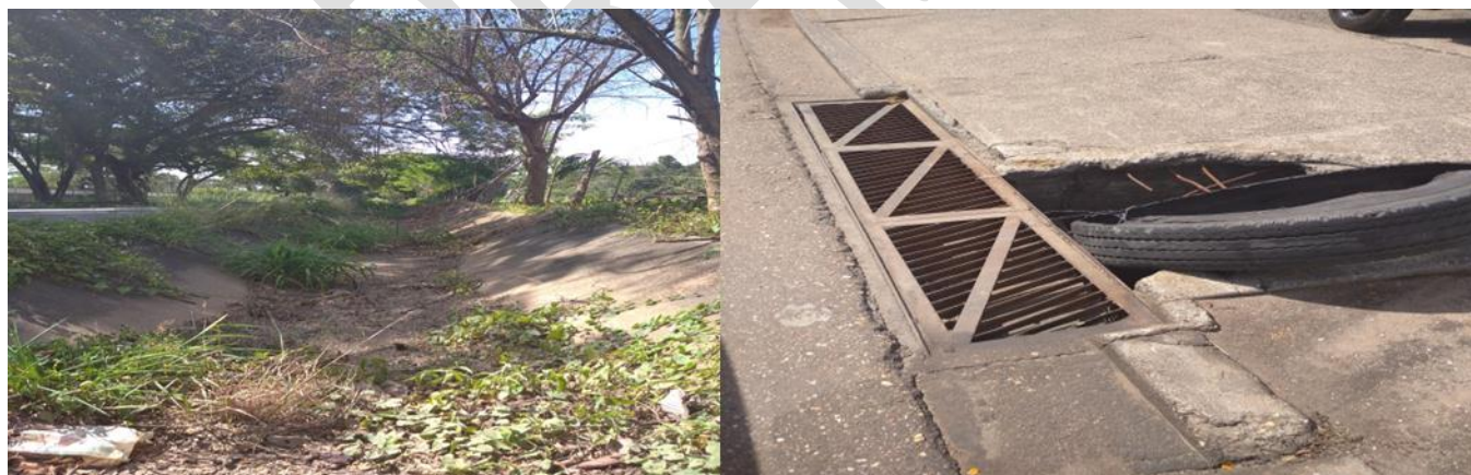
Fig. N° 37: condición física de los elementos de drenaje longitudinal Fuente: Moreno y Leon (2019)
