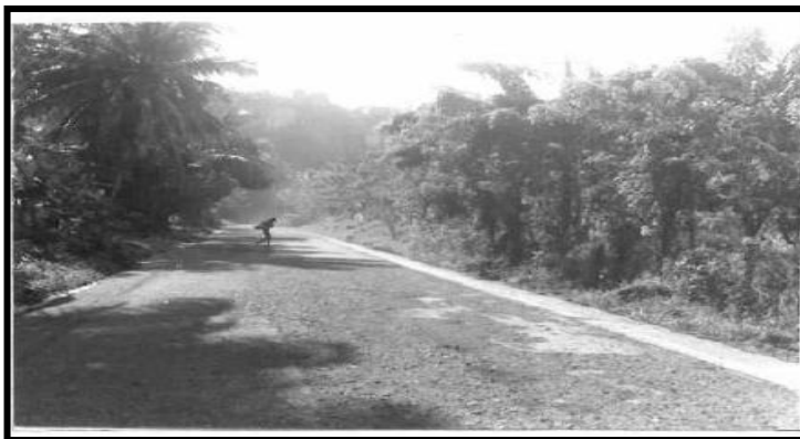
Figura N° 21: Desprendimientos Fuente: Gómez y Martínez (2010)
