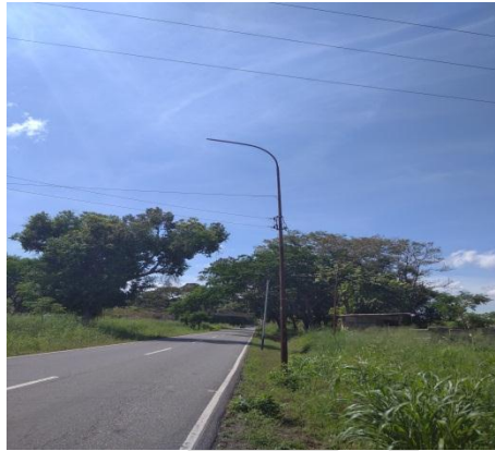
Fig. N° 41: Condición física y funcional de los postes de luz de la avenida Fuente: Moreno y Leon (2019)
