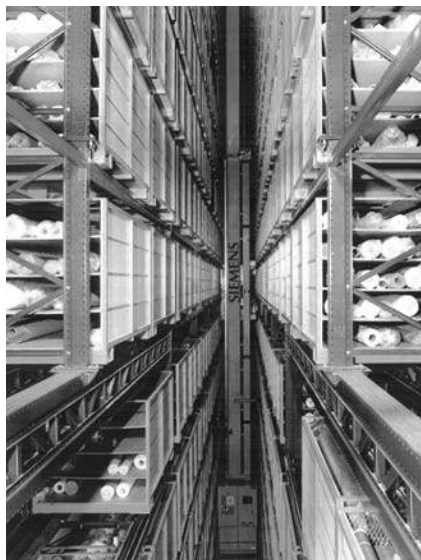
(Figura 22.9) Silo automático de palets
