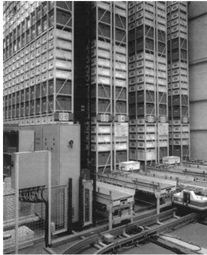
(Figura 7.8) Transelevador de cajas
